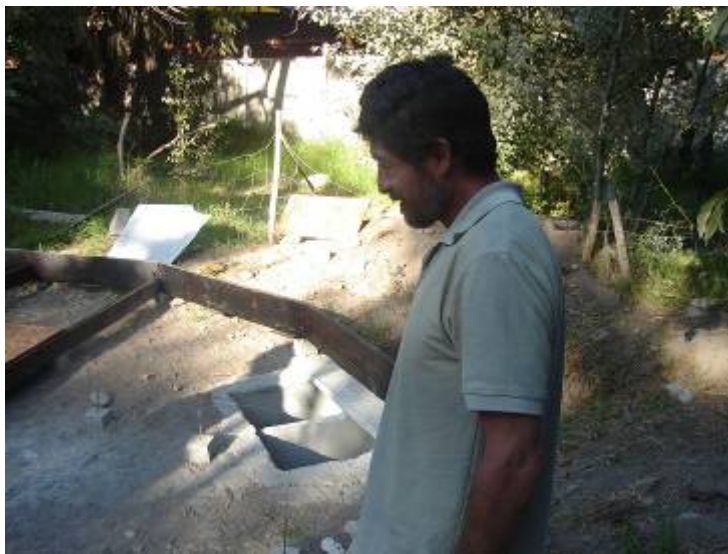
Juan Tapia, en su primera visita al domo, observando la nivelación deficiente de los apoyos de las vigas. Marzo de 2007.
